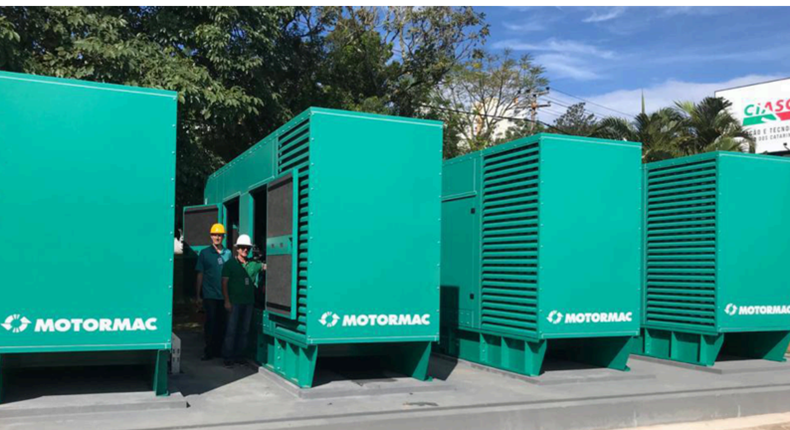
Geradores do CIASC.
